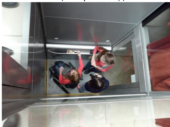
Вертикальный подъемник в шахтном ограждении
